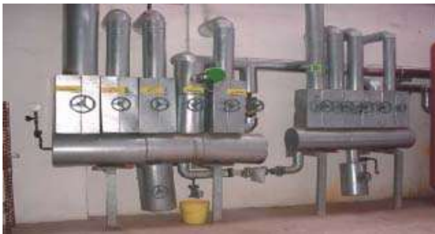
Abb. 19: Vorbildliche Wärmedämmung an Leitungen und Armaturen des Warmwassernetzes
